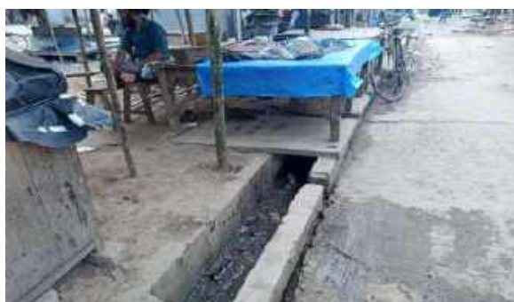
Fig: unhygienic drainage system
